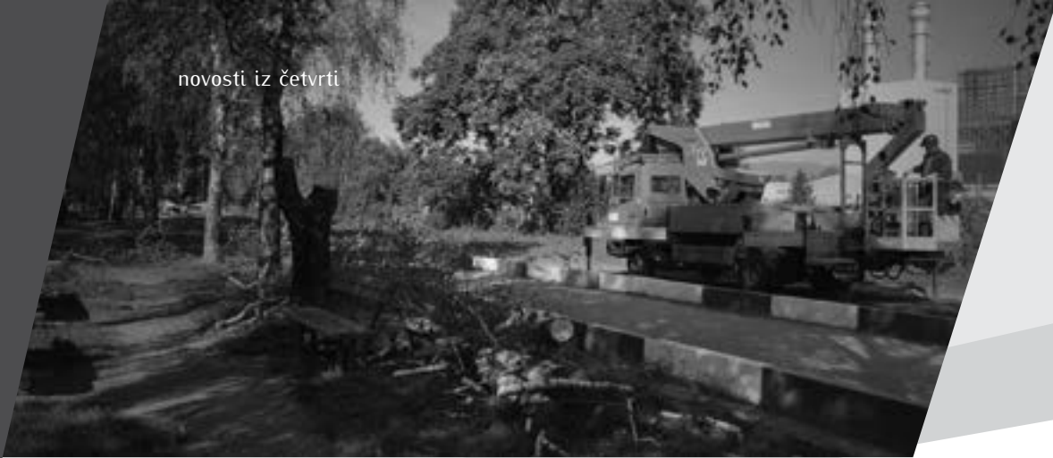
Radovi na postavljanju uspornika u Trakošćanskoj kojom dnevno prolaze brojna djeca na putu u vrtić ili školu
